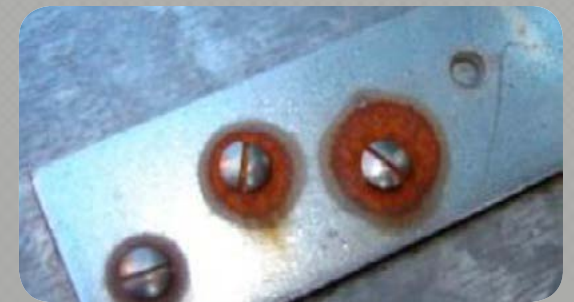
Contactcorrosie koper en zink.
