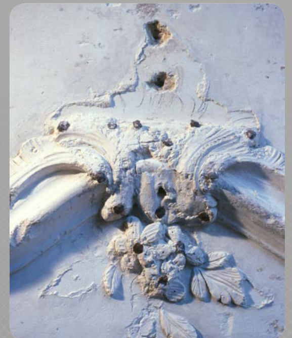
Stucwerk afgebroken door corrosie van smeedijzeren spijkers.
