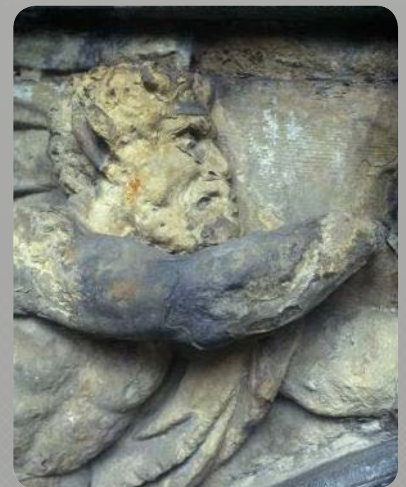
Extreme afbladdering veroorzaakt door hydrofuge.
